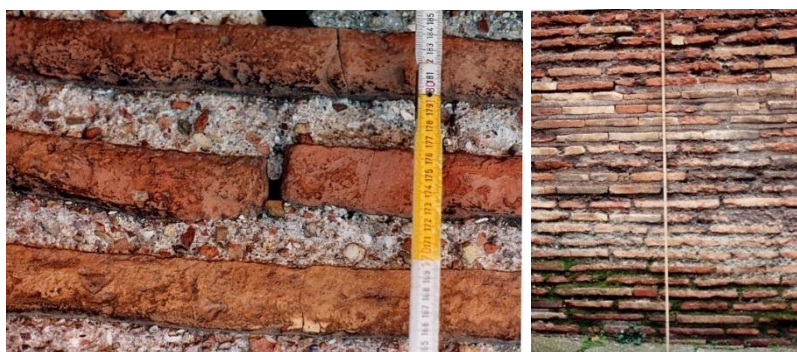
Da sinistra a destra: dettaglio del muro di facciata sul lato sud-ovest della Basilica di San Vitale, Ravenna; muro esterno della Basilica di San Vitale dove i lavori di restauro sono visibili. Foto di Nora Lombardini, dalla Tesi di Dottorato di Nora Lombardini.
